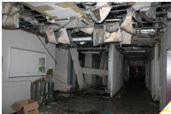
津波で損傷した仙台火力発電所4号機の1階
