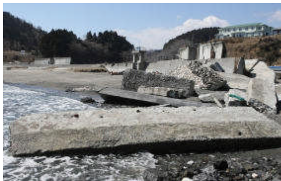
25メートル前後の津波が到達した大船渡市の綾里白浜地区。防潮堤が破壊され、陸地に飛ばされた
